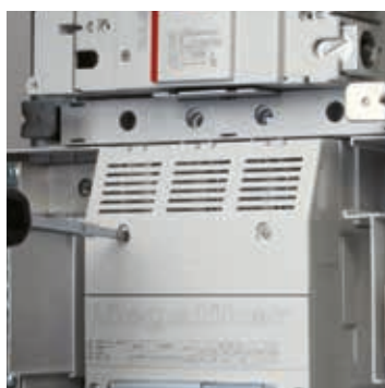
CUBIERTA AISLANTE INTERRUPTOR PRINCIPAL
