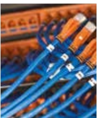
Conexión de routers y servidores
